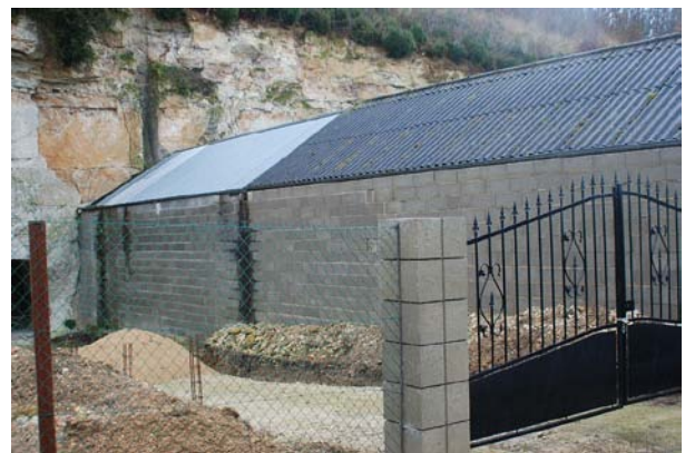
Construction troglodyte aux allures de hangar, fragilisant grandement la qualité du site
