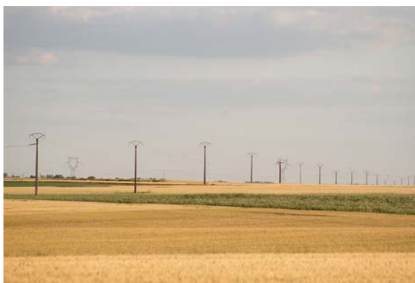
Problème de réseau aérien au cœur des paysages de Beauce, Villaugon
