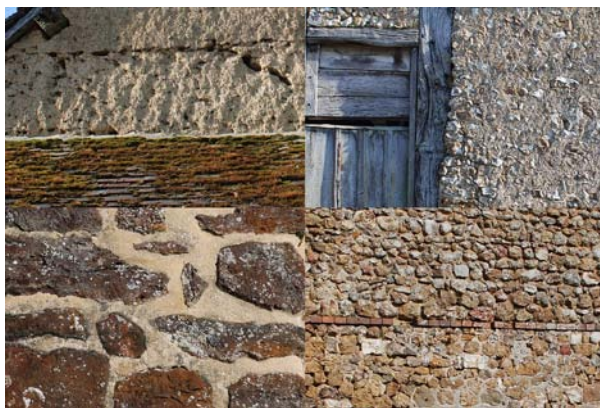
Mélange de matériaux variés dans la construction percheronne : torchis, pans de bois, ragnons de silex, roussard, moellons calcaires...
