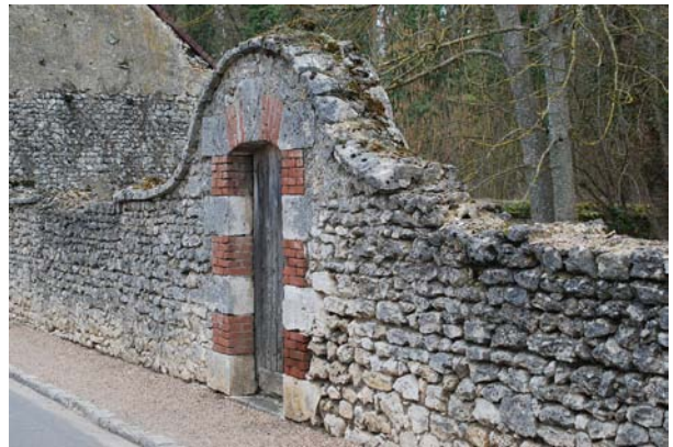
Beau mur de pierres calcaires participant à la qualité architecturale du village de Saint-Bohaire
