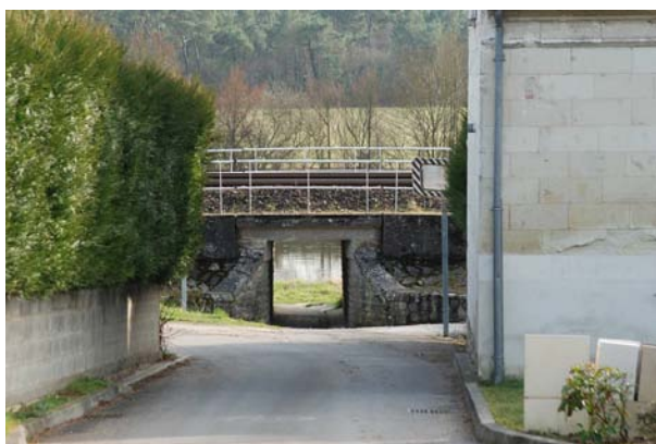
Problème de traversée des voies ferrées
